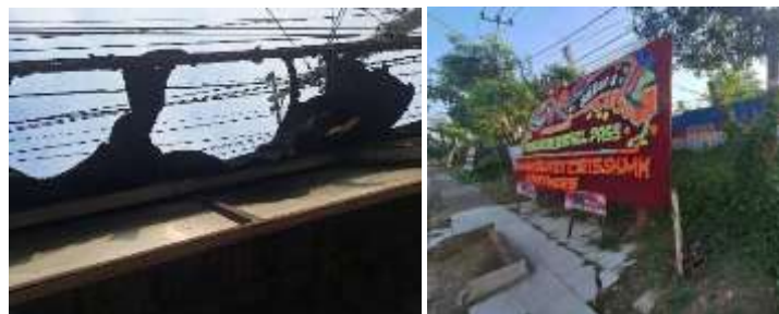
Gambar 1. Kerusakan Halte di Palembang
